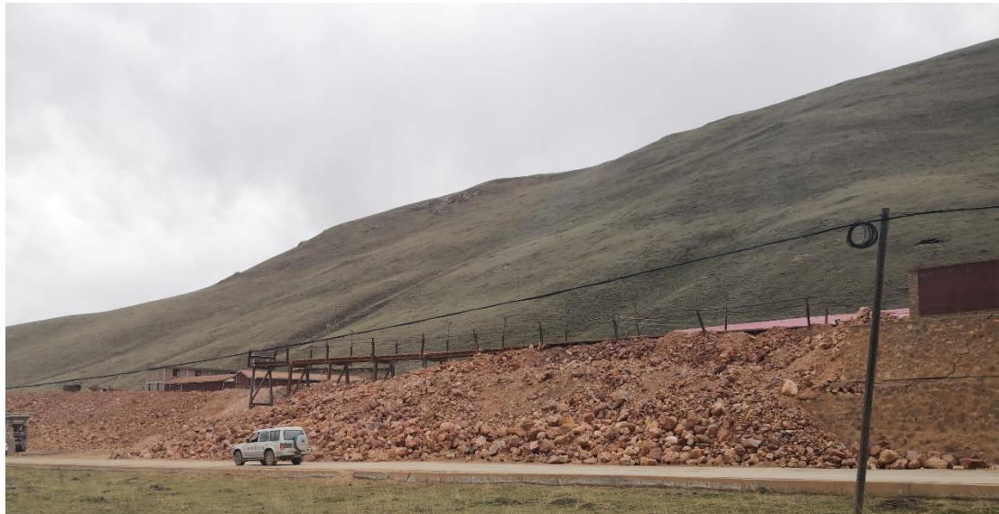
挡土墙损坏处
